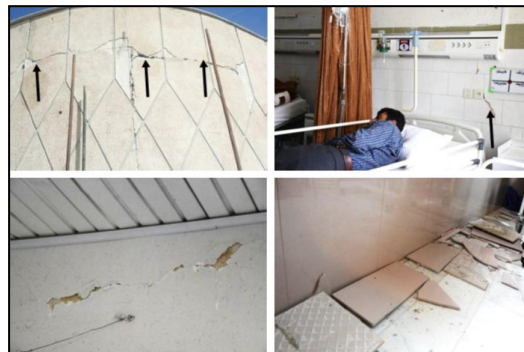
شکل (۱): خرابی بیمارستان‌های یاسوج در اثر زلزله ۵/۲ ریشتری.
