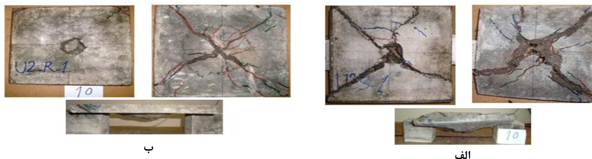
شکل ۹. الگوی گسیختگی نهایی؛ (الف) پانل U-S و (ب) پانل U-R؛ (راست) وجه پشتی و (چپ) وجه جلویی
